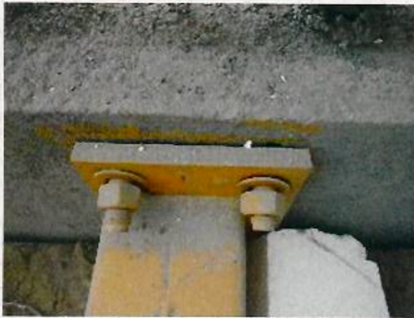
Fotografía N° 13: se observan varillas de anclaje con sus tuercas sin el suficiente torque, en parrilla soportante de los equipos recuperadores de aire.
