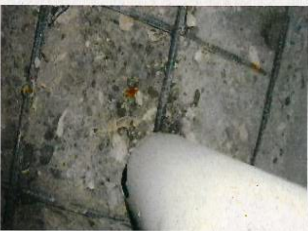
Fotografías N° 5: se observa armadura a la vista, por picado posterior de loza.
