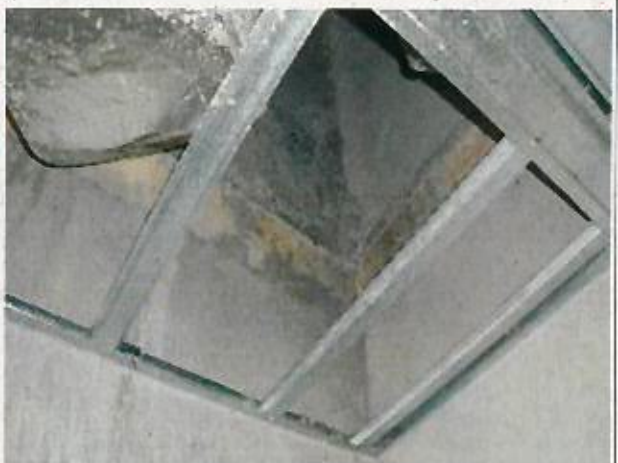
Fotografía N° 18: se aprecia restos de madera de los moldajes que no han sido retirados.
