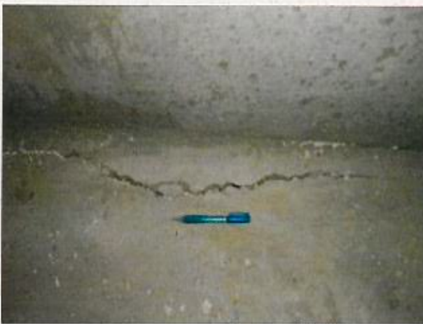
Fotografía N° 15: se observa grieta en losa de multicancha techada.
