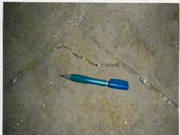
Fotografía N° 14: se logra apreciar grieta y fisura en losa de multicancha techada.
