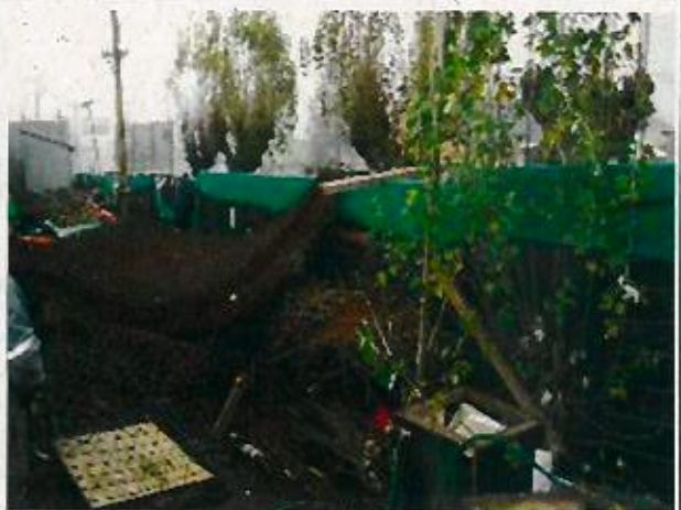
Fotografía N° 16: se aprecia un acopiado de mallas Acma que aún son utilizadas en la obra, sin resguardo para evitar la oxidación.
