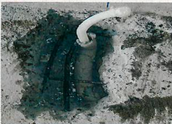
Fotografías N° 6: armadura a la vista y doblada, para dar espacio a flexible de calefacción.
