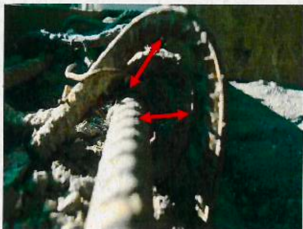
Fotografía N° 1: se puede apreciar una excesiva separación de los estribos en relación a las barras longitudinales.
