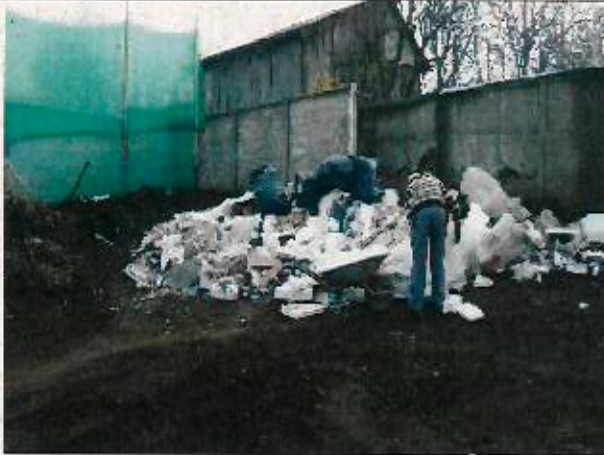
Fotografía N° 1: gran cantidad de basura y desechos de la obra, en contacto directo con el suelo y sin que estos hayan sido dispuestos para su eliminación.
