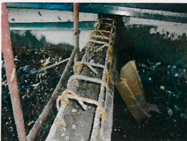
Fotografías N° 3: se aprecia viga de fundación donde se observó la misma irregularidad en los estribos.
